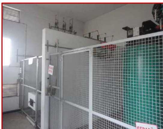
Vista Interna da Subestação II
