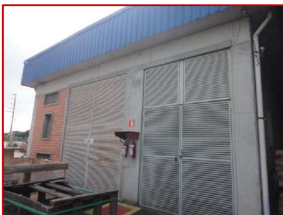
Vista Externa da Subestação II
